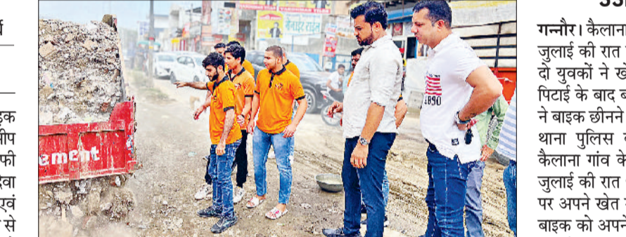
गन्नाई। समाजसेवी देवेन्द्र कादियान सड़क के गड्ढों को भरवाने के साथ मरम्मत करवाने का कार्य करवाते हुए।
